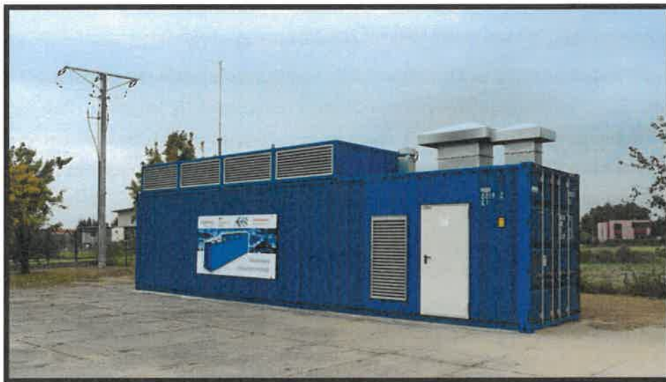
Zdjęcie 6 Przykład magazynu energii
