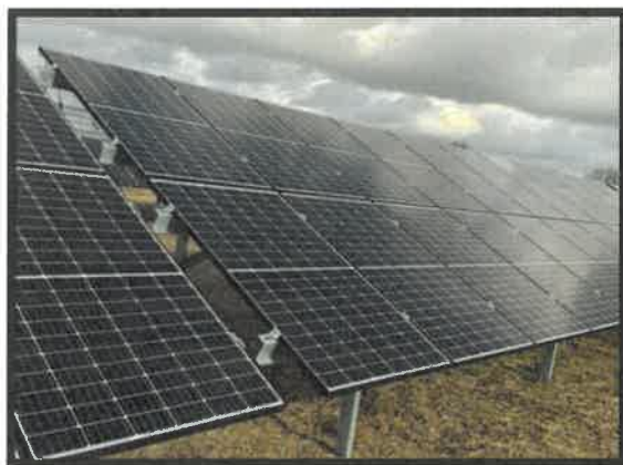
Zdjęcie 1 Monokrystaliczne panele fotowoltaiczne
