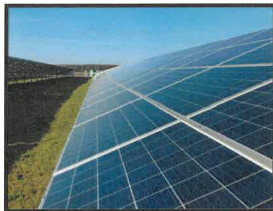
Zdjęcie 2 Polikrystaliczne panele fotowoltaiczne
